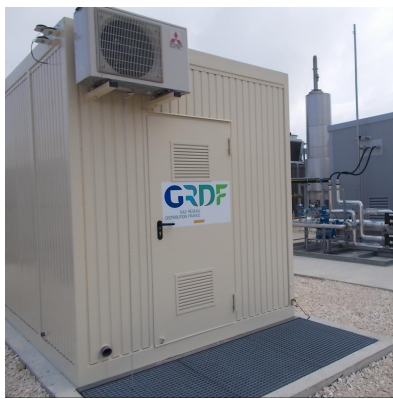
Le poste d'injection
