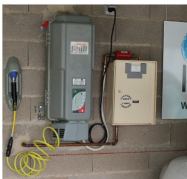
Appareil de remplissage de gaz naturel pour véhicules fabriqué par BRC FuelMaker, installé par WH2.
