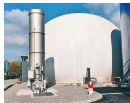
Le gazomètre et la torchère, à côté du digesteur (bleu)
